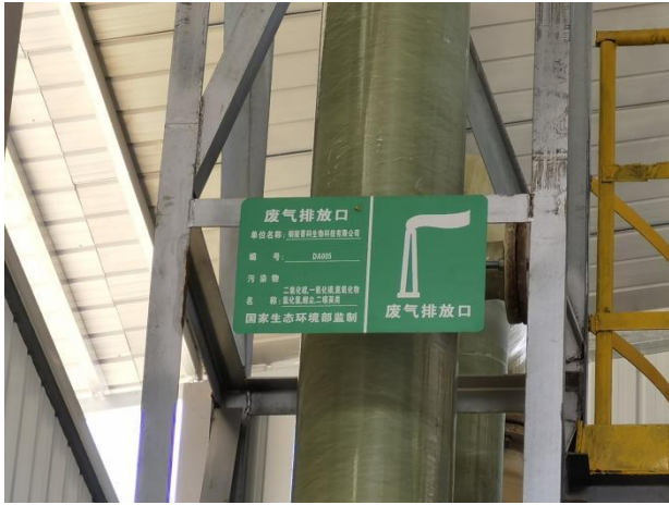
焚烧废气排放口 DA005
